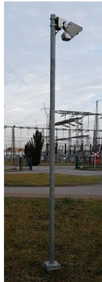
Słup P3000-1 na fundamencie F1 z zewnętrzną czujką ruchu
