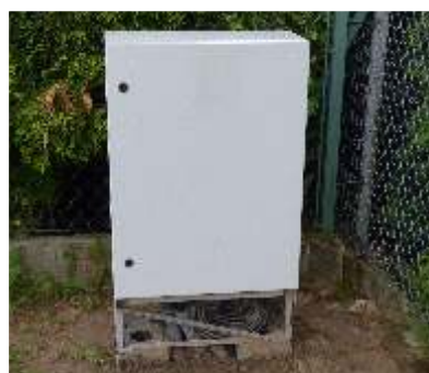
Fundamenty F1 z szafą
